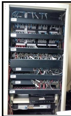
Ilustración No. 14. Situación actual rack
