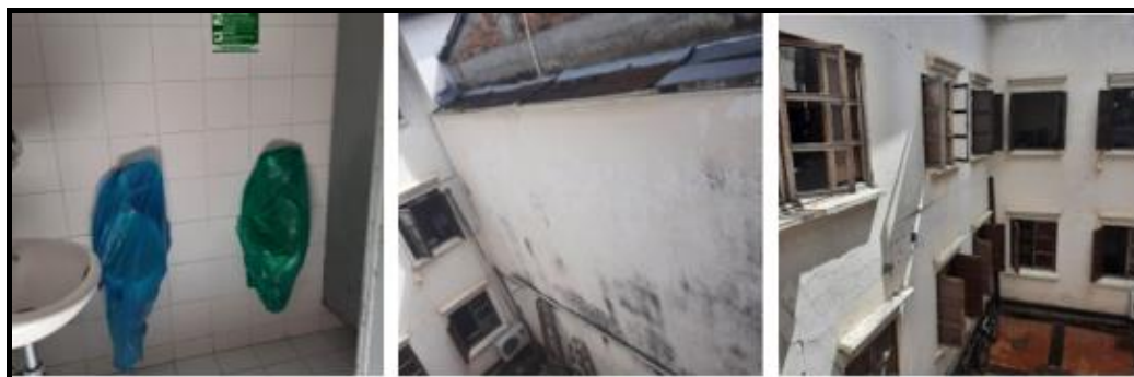
Ilustración No. 5. Problemas de deterioro de la infraestructura D.T Cauca
