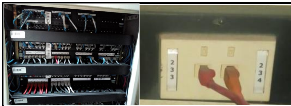
Ilustración No. 17. Marquillado de cables y puntos de red
