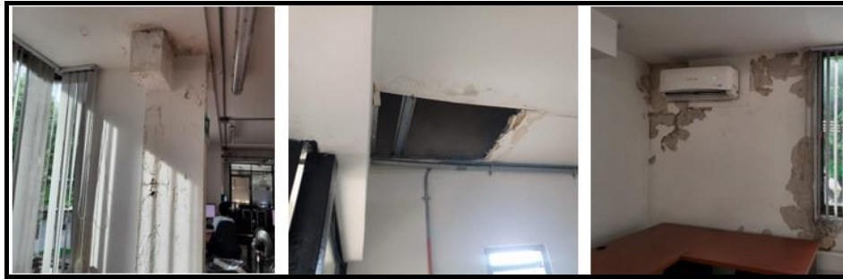
Ilustración No. 8. Problemas de humedad en paredes y techo tercer piso D.T Caquetá
