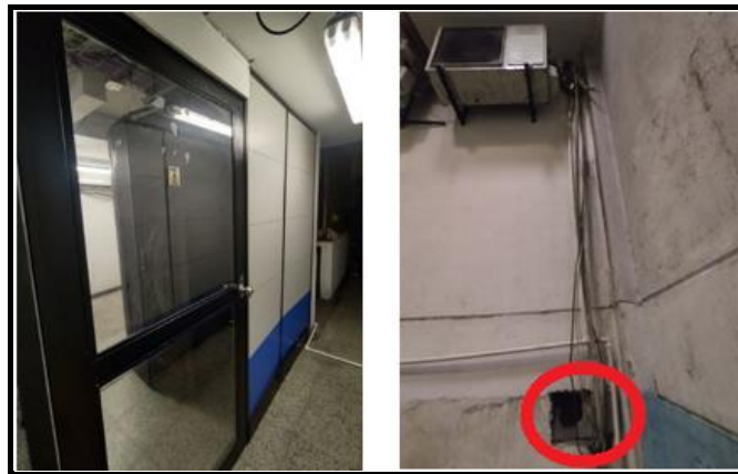
Ilustración No. 16. Vistas anterior y posterior área de ubicación rack y UPS
