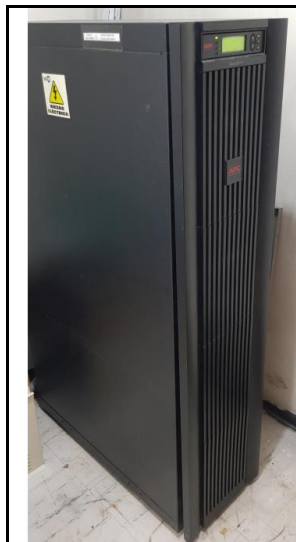
Ilustración No. 14. UPS
